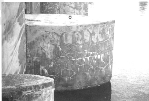
Fig. 11 b Rissmønster på 78 år gammel dam i lavlandet og med høyere fukttilgang
