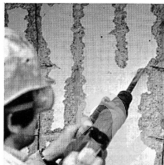
Fig. 121 Borthogging av løs og dårlig betong [521]
